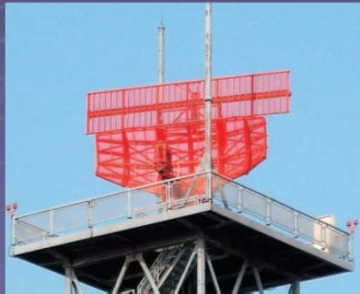
空港監視レーダー
